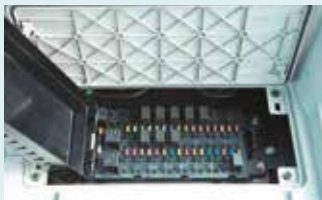
Leicht zugänglicher Sicherungskasten.
