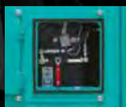
Vanne manuelle de descente d'urgence de la cabine
