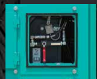
Valvola manuale di emergenza per l'abbassamento cabina
